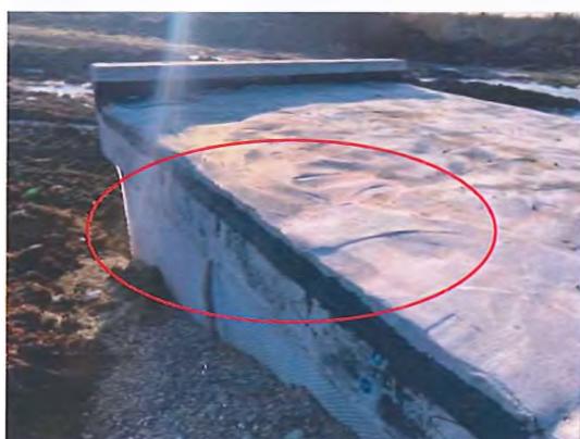
Fig. 6.5.32-4 - Hidroizolația nu se continuă și peste capetele dalelor
