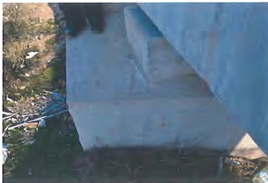
6.7.11-5 Fisuri în bancheta culeei C2
