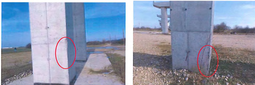
Fig. 6.7.5-3 Degradări pile (muchii lovite)
