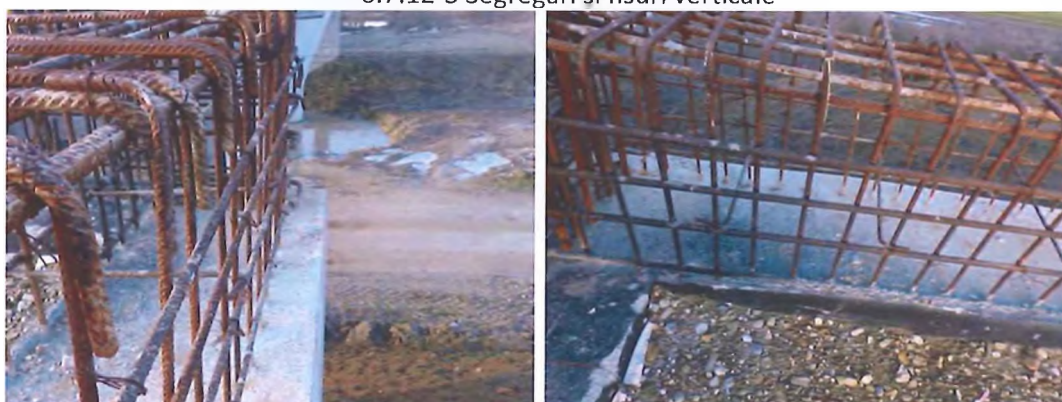
6.7.12-4 Dezaxare carcasă armatură la zid întors amonte - Culee mal stâng
