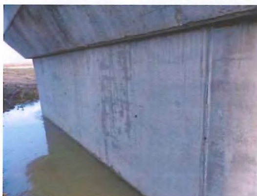
6.7.12-3 Segregări și fisuri verticale
