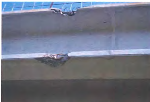
Fig. 6.7.6-2 Degradări pile (muchii lovite)
