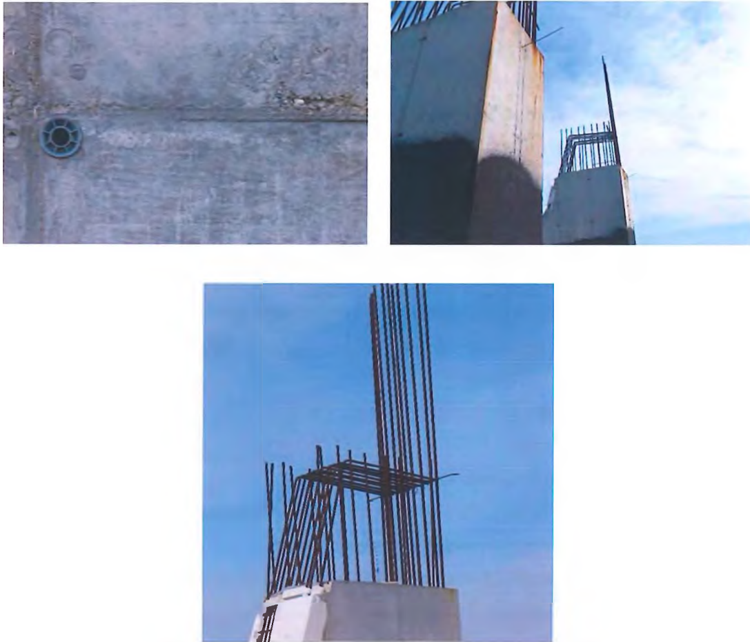
Fig. 6.7.1-2 Aspecte elevații culee – Zone cu segregări
