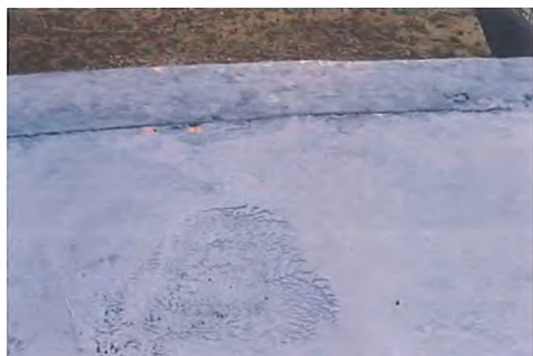
Fig. 6.7.6-6 Finisare necorespunzătoare a suprafeței plăcii de suprabetonare
